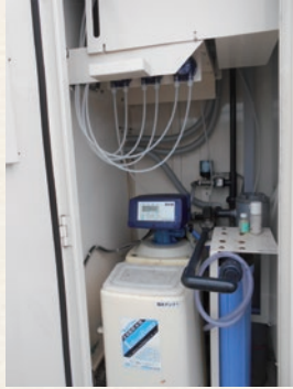
↑電解水生成装置
